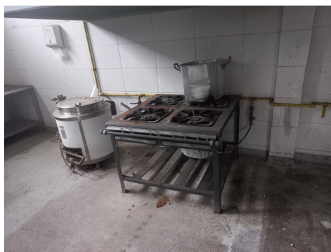
Um fogão industrial de 4 bocas, enferrujado.
